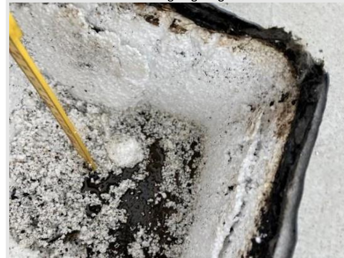
Billedet viser hultagning i randområde i tagets nordlige ende, hvor der ses vand under flamingoen/EPS-polystyrenen.
